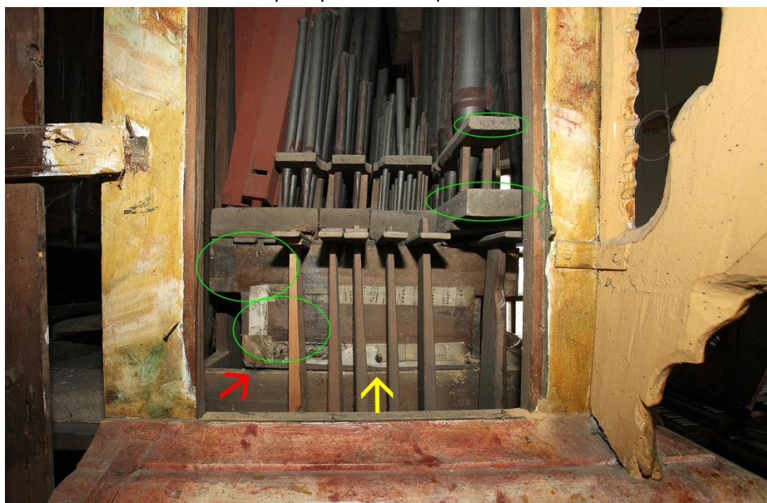
Foto č. 9: červená šipka – odtržení vzdušnice od uložení
