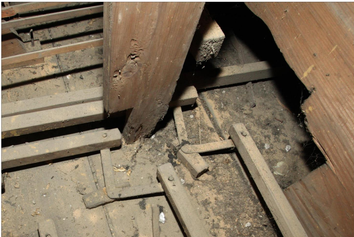
Foto č.3: Vyřezání a oslabení vnitřních konstrukcí, detail vedení rejstříkové traktury s přibitím mezi dvě prkna podlahy
